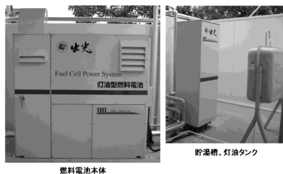
図 4. SS における灯油型燃料電池システムの設置
