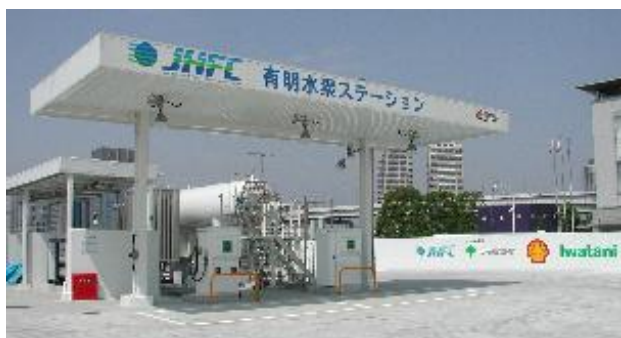
図-6 : 水素ステーション
