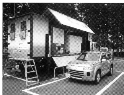
丸彦製菓工場内の日光水素ステーション
